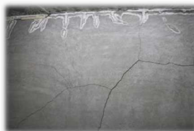
施設壁面の亀裂
