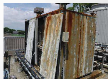
経年劣化で故障した空調機
