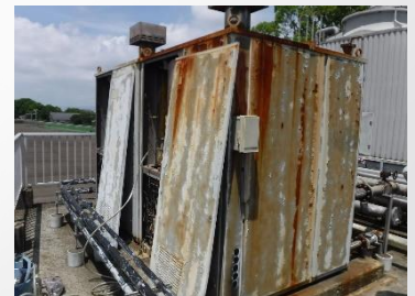
経年劣化で故障した空調機
