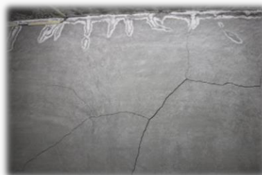
施設壁面の亀裂
