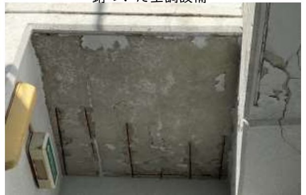
【メインスタンド外部廊下】内部鉄筋が露出 (雨水浸透のため鉄筋が錆びつき、コンクリートが剥離)
