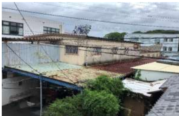
【旧集計センター】 錆びついたトタン屋根
