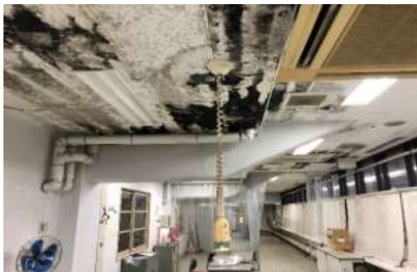
【メインスタンド地階】 漏水で天井劣化のため閉鎖中
