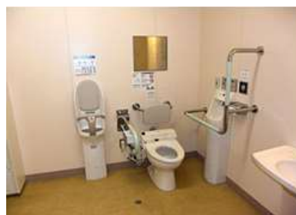
【ベビーシート等を備えた多機能トイレ (静岡競輪場)】
