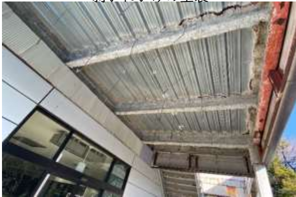
【正源氏プラザ】落下した軒天井 (鉄骨耐火被覆が露出し、風雨のため剥がれている)
