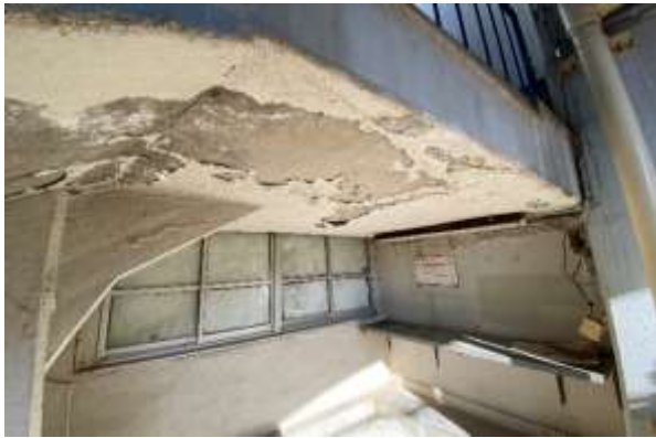
【メインスタンド軒】 剥がれかけの塗装
