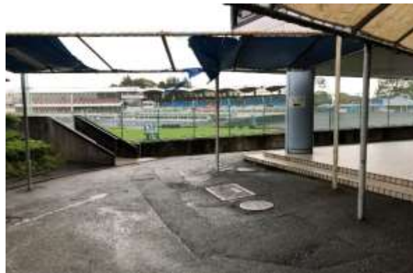
【サービスセンター】 破損した渡り廊下
