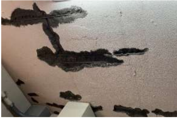
【無停電装置室】内部鉄筋が露出 (コンクリートが剥離し鉄筋が露出。強度的に不十分な状態)
