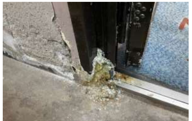
【メインスタンド地階】 雨水が浸透しコンクリート成分が表出
