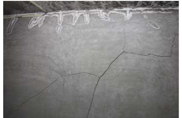
【メインスタンド】 コンクリート壁面のひび割れ
