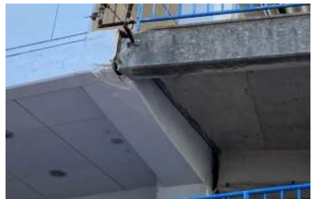
【メインスタンド渡り廊下】 増築箇所の躯体破損
