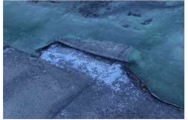
【正源氏プラザ屋上】剥がれた防水シート (一度補修した箇所が、経年変化により再度剥がれている。)
