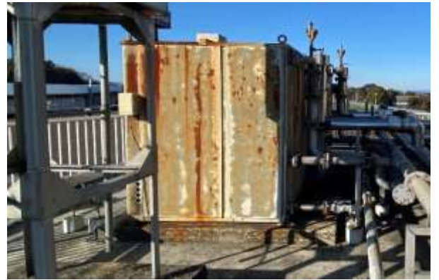
【正源氏プラザ屋上】 錆ついた空調設備
