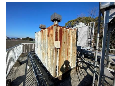
【正源氏プラザ屋上】 錆びついた空調設備
