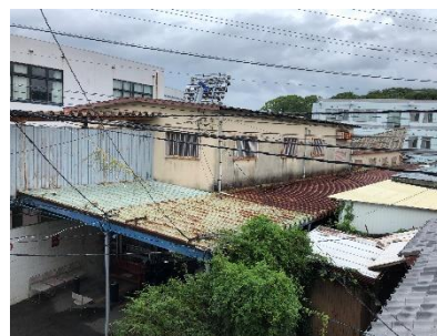
【旧集計センター】 錆びついたトタン屋根
