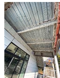
【正源氏プラザ】 落下した軒天井
