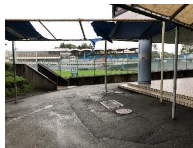
【サービスセンター】 破損した渡り廊下
