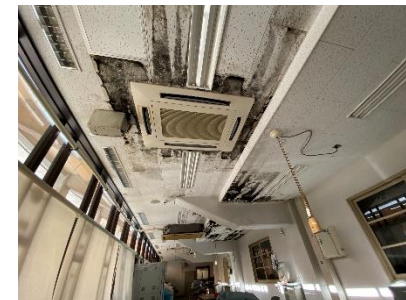
【メインスタンド地階】 漏水により天井破損
