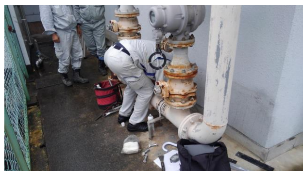
平成29年10月6日ガス漏洩 第5・6発売所吸収式冷温水機付近バルブ
