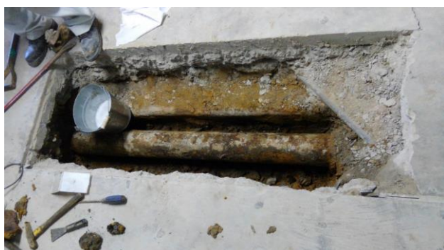
平成29年9月29日ガス漏洩 メイン特別観覧席1階警備研修室付近(鋼管老朽化による)
