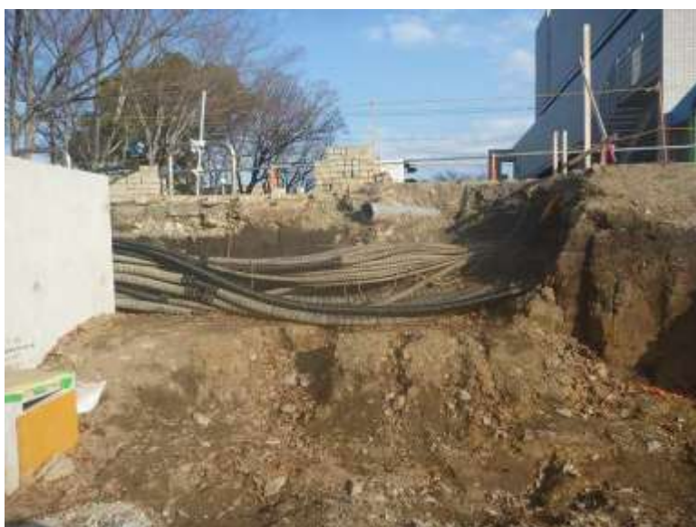
地中埋設ケーブル露出状況 (グラウンド東側部北角)
