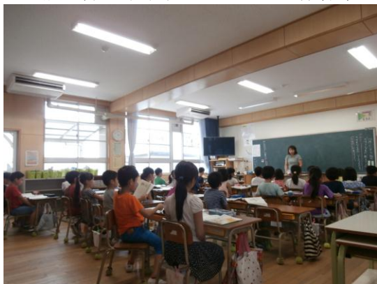
エアコンが設置された普通教室
