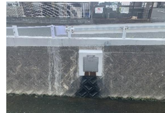
嵩上げ・フラップゲート
