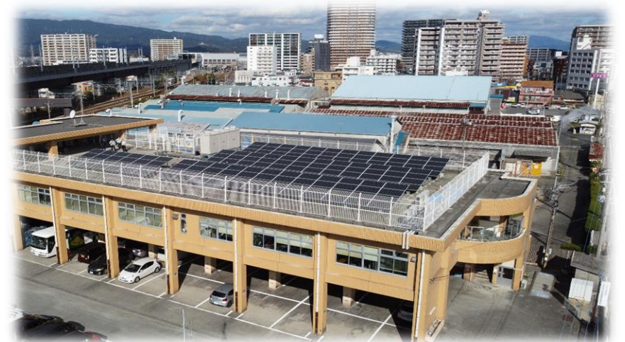
久留米市環境部庁舎設置の太陽光パネル
