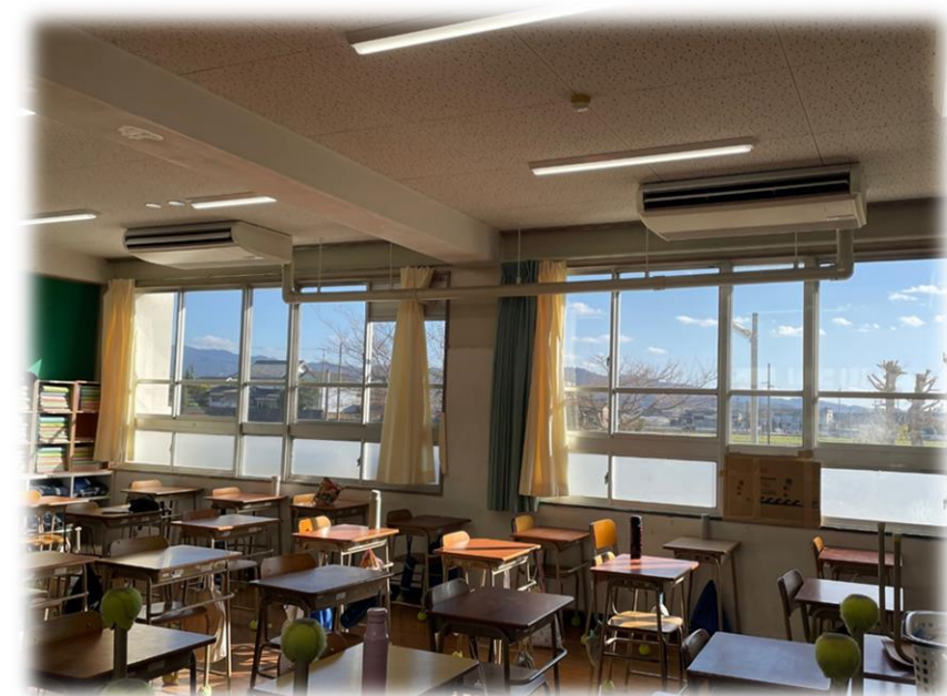
普通教室設置の空調機
