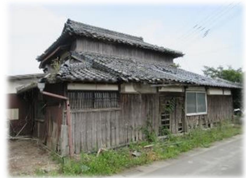
老朽危険空家
