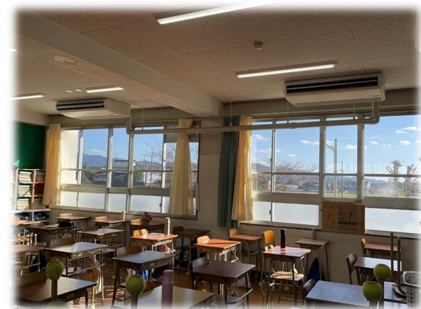
普通教室設置の空調機
