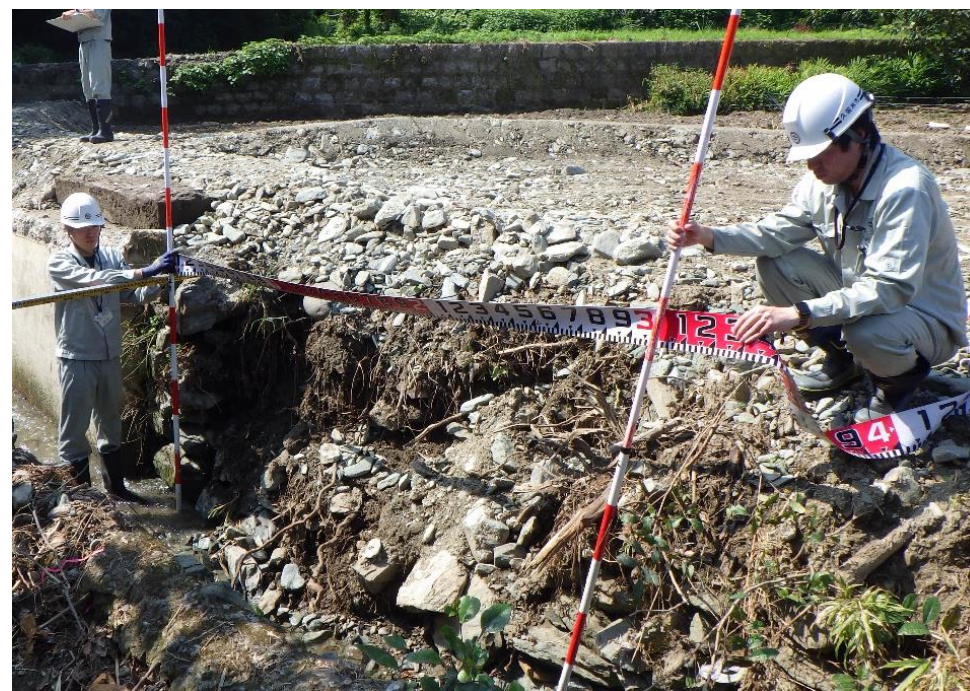
市管理河川の損壊部分を測量
