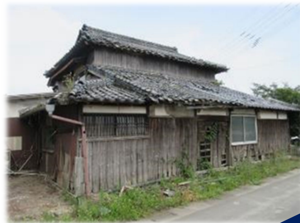
老朽空家の状況
