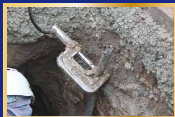
漏水した埋設管の一部 管から水が噴き出さない様に止め工事を進める
