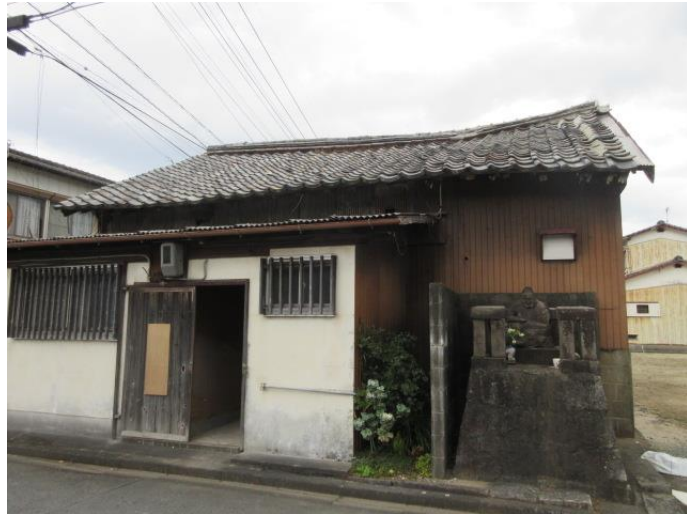
屋根が落ち込んでいる
