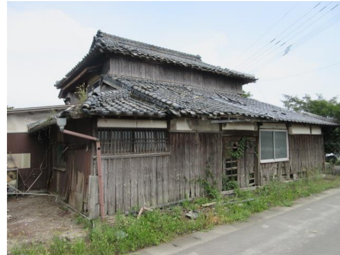
瓦が全面的にずれて穴も
