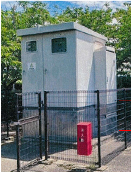
既設キュービクル外観写真
