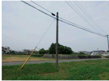
㉔Ⅱ期政庁地区：電柱
