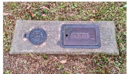
図 5-8-6 散水栓のイメージ （史跡土塔）
