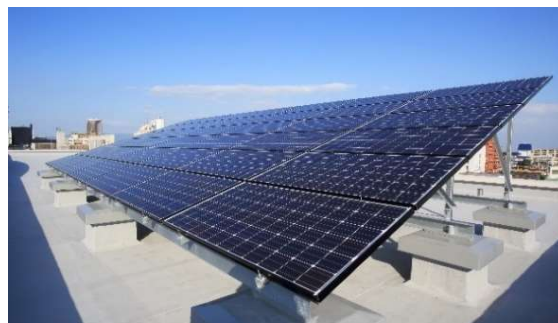
【太陽光発電の設置】
