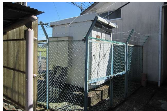
【受変電設備の老朽化】
