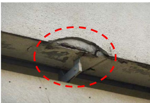
【モルタル剥落】
