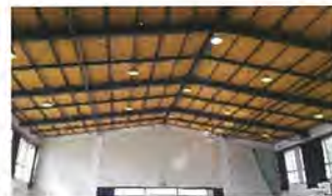
改修前（水銀灯）
