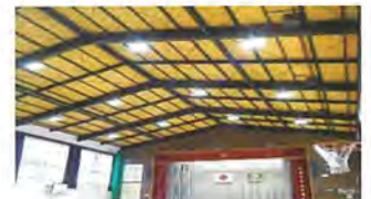
改修後（LED照明）
