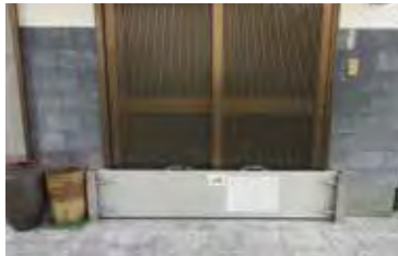
玄関前に設置した止水板
