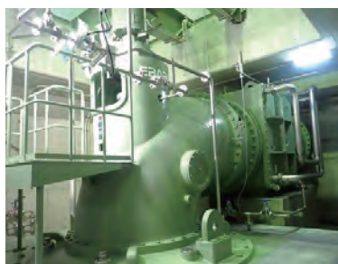
排水能力が1.2倍になった 篠山排水ポンプ場
