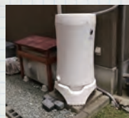
自宅で雨水をた めるタンク
