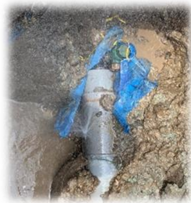
ビニル製配水管の漏水状況
