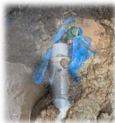
ビニル製配水管の漏水状況
