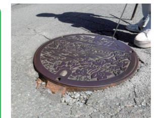
マンホール蓋のぐらつき
