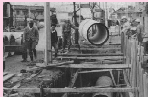
下水道管布設工事の様子(昭和40年代頃) 「目で見える久留米の歴史」より転載
