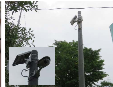
簡易監視カメラ設置(例)
