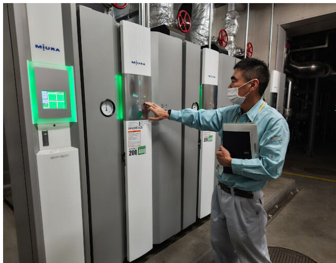
ボイラー室は静かですともきれいでした
