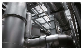
プラント配管
