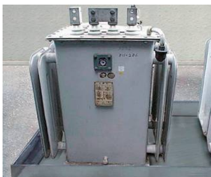
【変圧器(トランス)】
