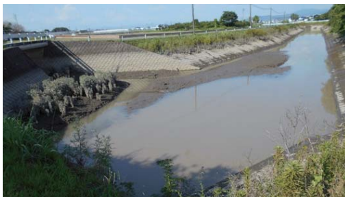
土砂が堆積しているクリーク
