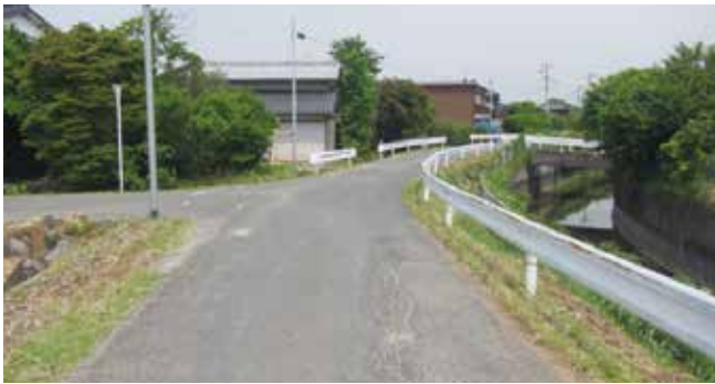
県道菅原豊城線の狭小区間
