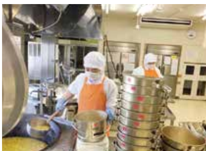
令和元年度に給食調理室に設置したエアコン
