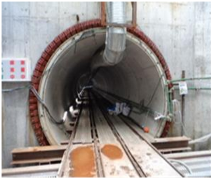
東櫛原貯留施設
