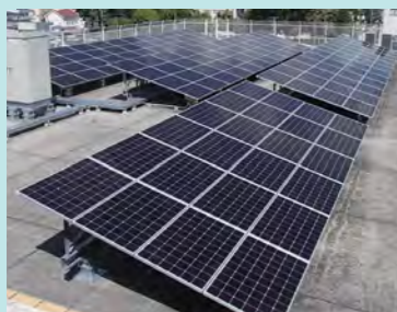
環境部庁舎の太陽光発電設備
