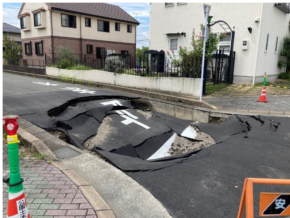
宮ノ陣道路陥没の様子
