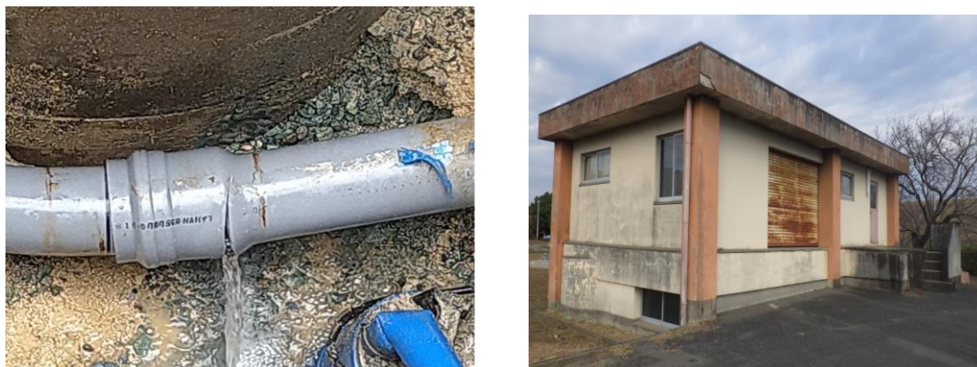
図 2-1-11 管路の破損や老朽化した構造物の様子
