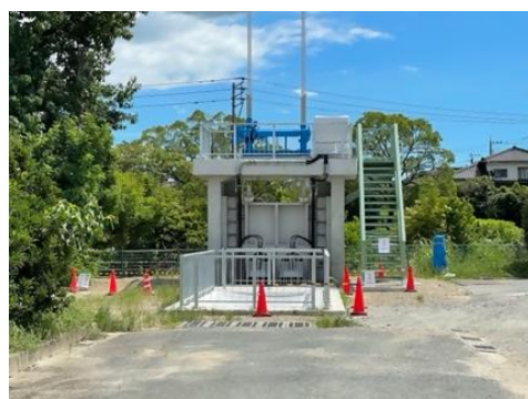
ゲートポンプ (R6.6 運用予定)
