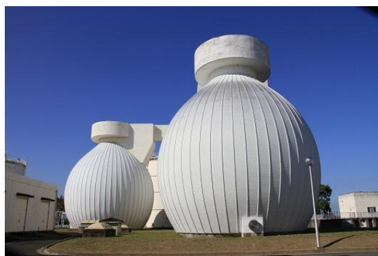
▲ 消化槽（南部浄化センター）
