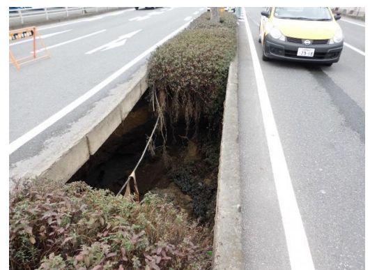
▲ 下水管路破損による 道路陥没の様子 【平成24年度久留米市東櫛原町】
